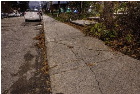
Photo 8 : le trottoir est irrégulier, avec le bateau pavé et les nombreuses fissures.
