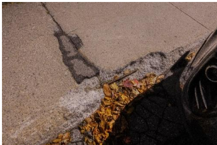
Photos 2 et 3 : Mauvais état de la chaussée.
